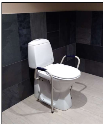
Sanitærutstyr i opprinnelig bygg, under lagring og montert i KA13. Foto: Anne S Nordby
