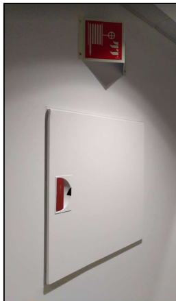
Brukt brannslangeskap fra DEG8 montert i KA13. Foto: Anne S Nordby
