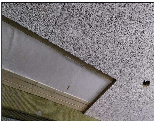
Himlingsplater i mineralull benyttet som akustisk demping over faste treullsementplater. Foto: Anne S Nordby
