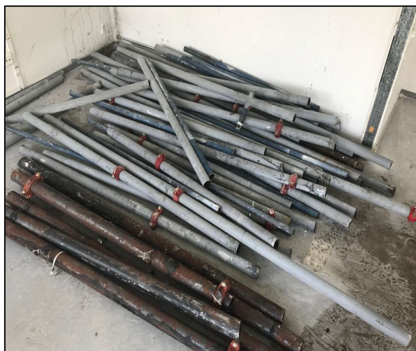
Brukte sprinklerrør, demontert fra U2. Foto: Christoffer Siopan Engtrø
