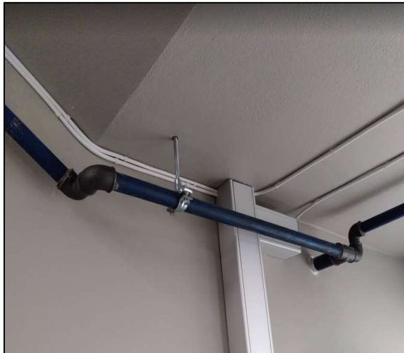
Brukte sprinklerør, ferdig montert. Foto: Anne S Nordby
